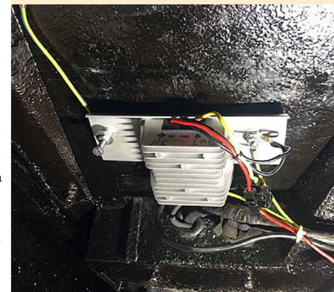
Spanningsstabilisator in Alvis op het binnenscherm Spanningskonstanthalter im Alvis - hinter Abdeckung Innenkotflügel
